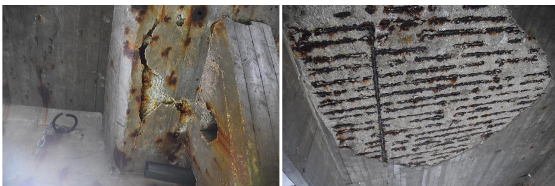
Foto: Multiconsult. Avskalling med kraftig korrodert armering.
