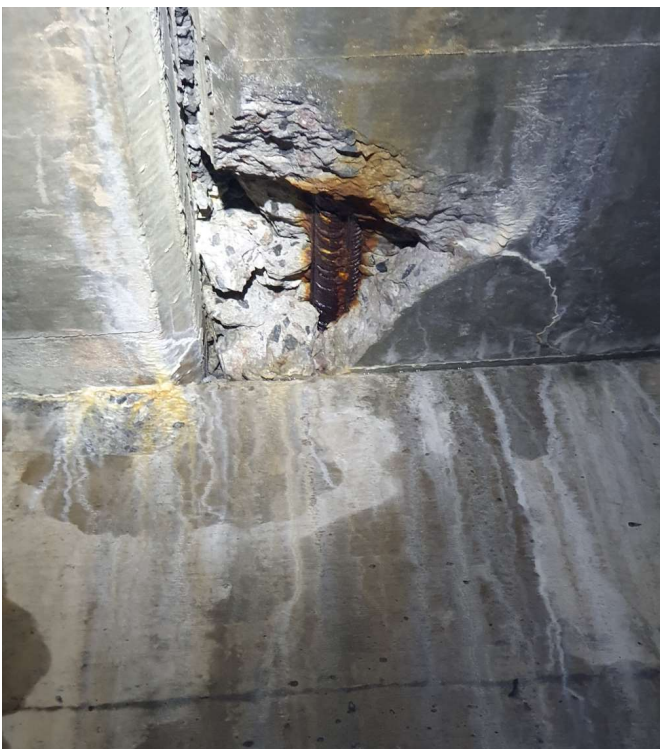
Foto 10 - Bilde fra 2023 - Avskalling underside av hjørne til betongelement overgangsplate ved opplegg på bakkantbjelke
