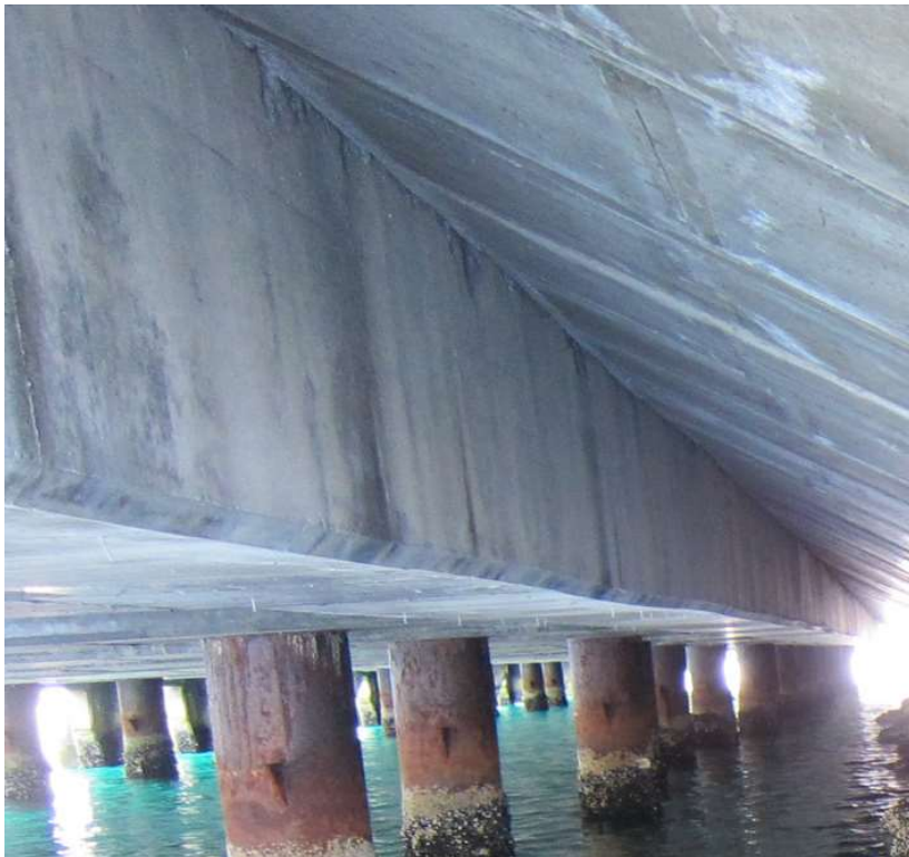
Foto 8 - Bilde fra 2015 - Avskalling langs oppleggs linjen på bakkantbjelke
