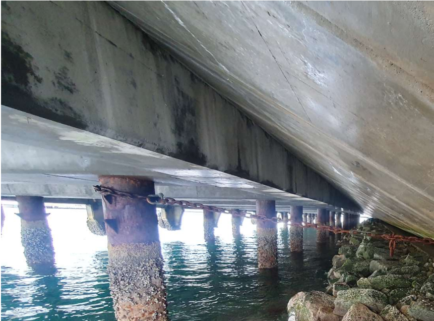
Foto 9 - Bilde fra 2023 - Avskalling langs oppleggs linjen på bakkantbjelke
